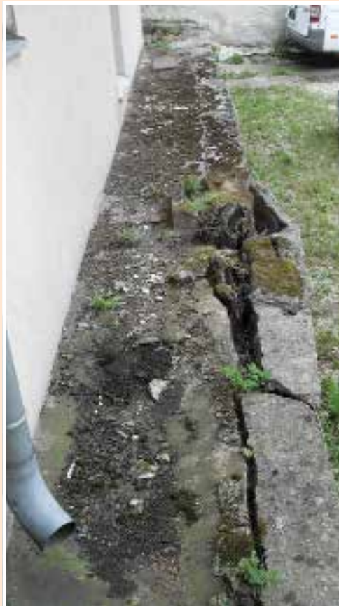
Abb. 1: Betonsockel hinter der Freibank im Höhnshof – die Ursache unseres Feuchtigkeitsschadens.
