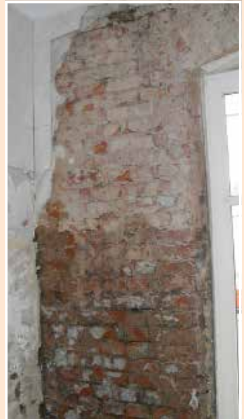
Abb. 2: Feuchtigkeit unter den Fliesen und die angestiegene Höhe.
